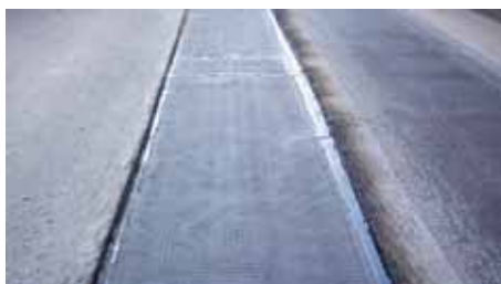
Scheurremmend asfalt over de matten in de voeg.
