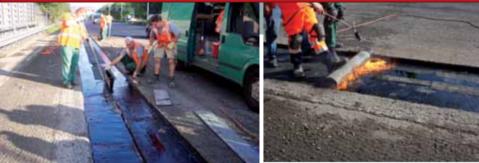
Aanbrengen van het flexibele, dubbellaags gewapend membraan dat met een ruime plooi in de voeg hangt. Afdekking met een stijve, met polyester en glasvliesvezel gewapende, mat.
